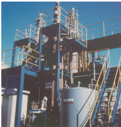
化成品洗浄廃水処理装置(川崎MS)
