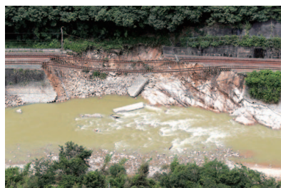
西日本豪雨による濁流で線路下の土砂が流出したJR山陽線(2018年7月11日、広島県東広島市)
