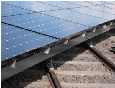
郡山ソーラーステーションの太陽光パネルはレールを撤去することなく設置されている
