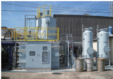
廃水処理設備のリニューアル (活性炭ろ過槽の導入など、2016年)
