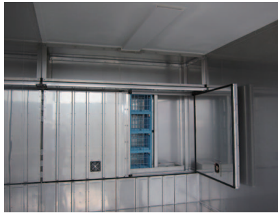
蓄冷室(右側のふたを取り外した状態)
