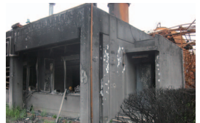
火災により全焼した五井営業所建物
